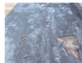
屋根防水層：一部ではがれ
