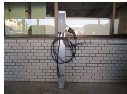
公用車充電設備
