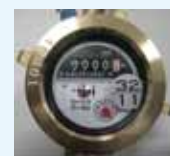
水道メーター写真
