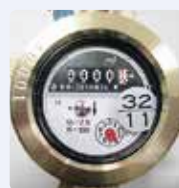
水道メーター
