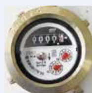
水道メーター
