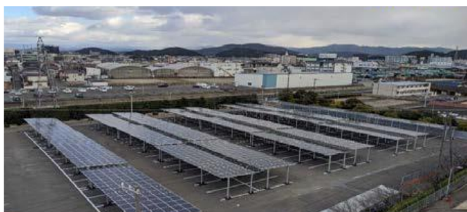
事業所駐車場へのソーラーカーポート導入事例 (花王和歌山工場) (出典:環境省ソーラーカーポート導入優良事例集(環境省))
